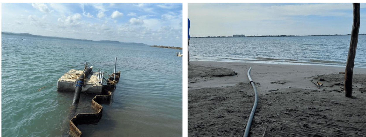
Figura 6-10. Tuberías de vertimientos identificadas en las playas de puerto velero y caño dulce.
